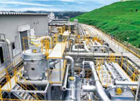
三重リサイクルセンター蒸発濃縮結晶化設備
