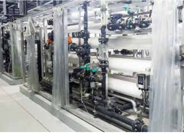
三重リサイクルセンター水処理施設 RO 膜処理装置
