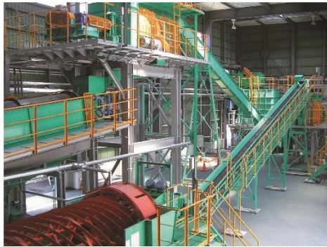
< 洗浄処理施設 >
