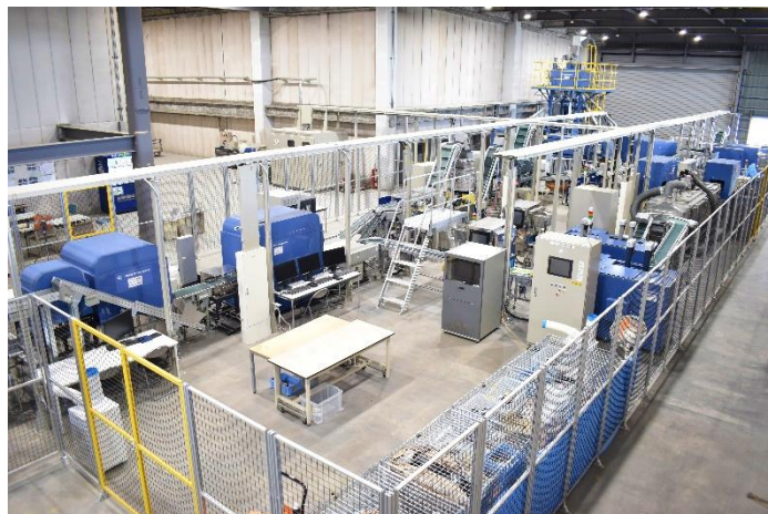
大栄環境グループ・DINS 関西株式会社(大阪府堺市)に設置された、 高品位小型家電を無人選別する CEDEST システム実証プラント
